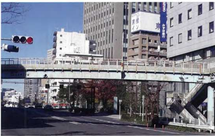
老朽化した永代2丁目の歩道橋
